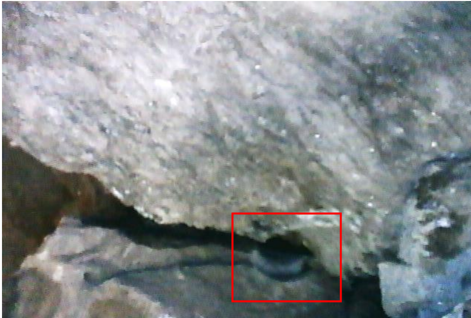
Foto 1 , 10 Luglio 2015, Aut. S. B., Foro AA, lato Sud. Perforazione e video ispezione in direzione Nord / ovest in corrispondenza del lato Sx del Basso Rilievo (circa metà altezza). Rilevata presenza di lesione interna; materiale individuato: pietra / vuoto / calcestruzzo.
