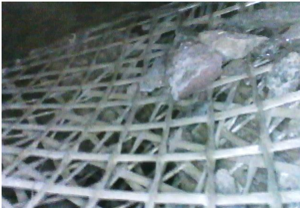
Foto 6 , 10 Luglio 2015, Aut. S. B., Foro BB, lato Ovest. L'ispezione ravvicinata sul fondo (dietro la parte bassa del Bassorilievo) è ben visibile la presenza di una rete e di frammenti di pietra di disgregazione (pietra rossa delle colonne).
